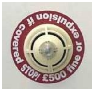
Détecteur de fumée/chaaleur dans la pièce
